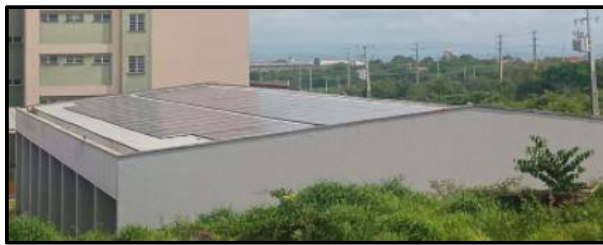
Figura 5: Placas Solares no campus de Juazeiro do Norte
