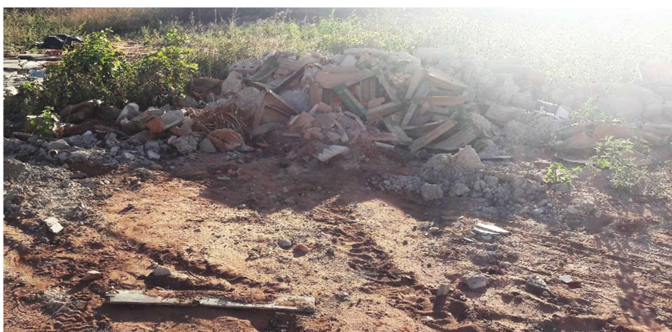
Figura 19 - Resíduos de classes A e B próximos à central de concreto
