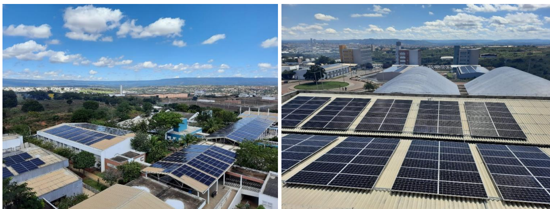
Figura 15 - Usina solar fotovoltaica instalada sobre as cobertas das edificações, campus Juazeiro do Norte
